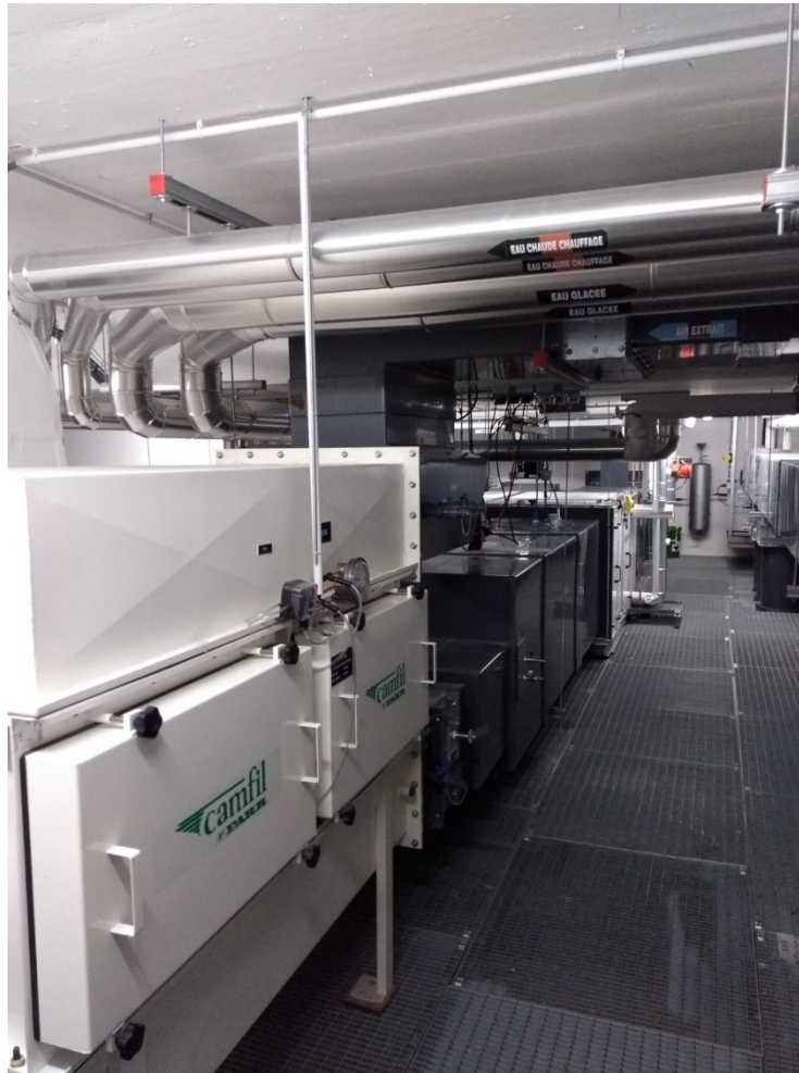
Imagem 6: Shafts e pavimentos técnicos – espaços exclusivos para equipamentos e sistemas. Edifício François Jacob, Instituto Pasteur, Paris, França. Fonte: Acervo do autor (2018).
